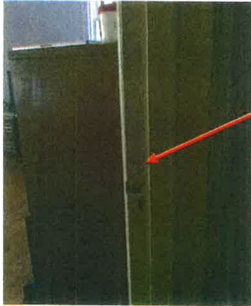
BEDROOM 5 - DOOR JAMB, SIDE C
